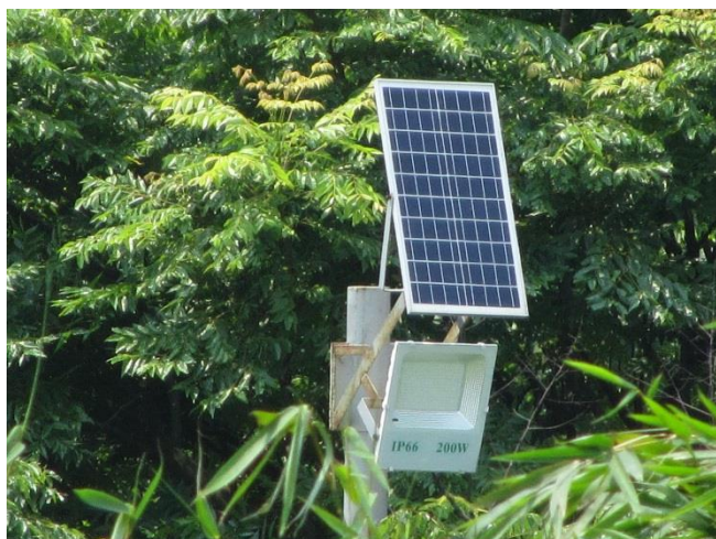
設置太陽光電照明設備系統
