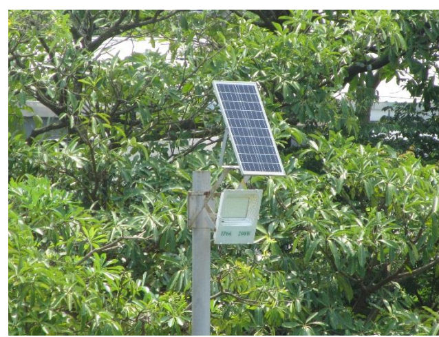
設置太陽光電照明設備系統
