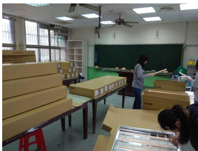
設置太陽光電照明設備系統
