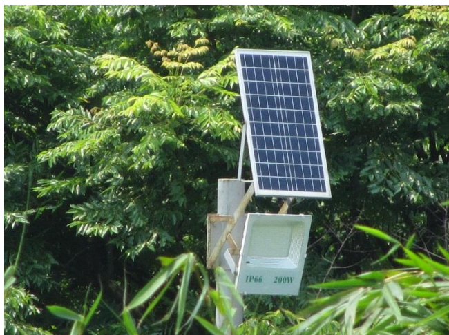
設置太陽光電照明設備系統
