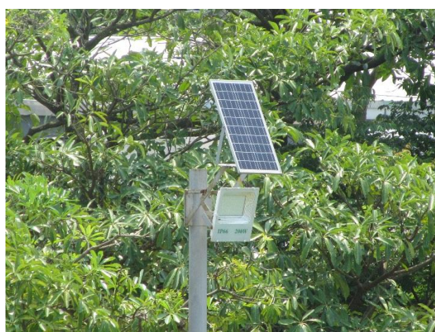
設置太陽光電照明設備系統
