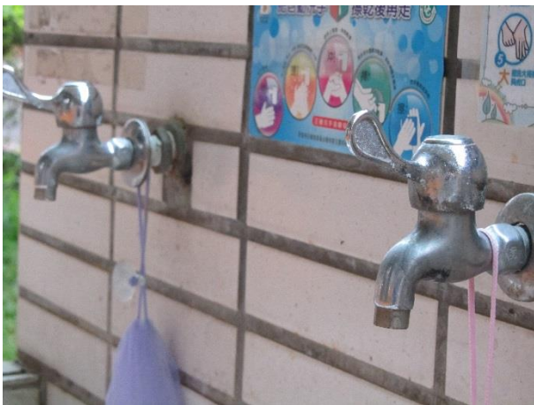
節約用水具體作為----裝設省水設備
