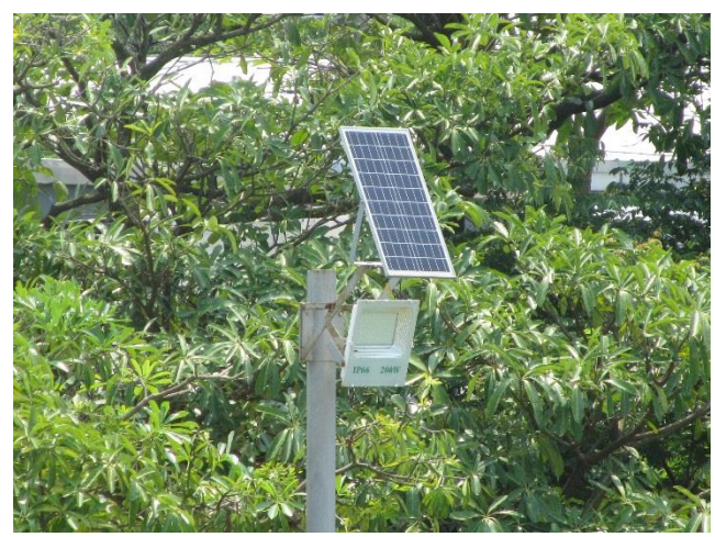
設置太陽光電照明設備系統
