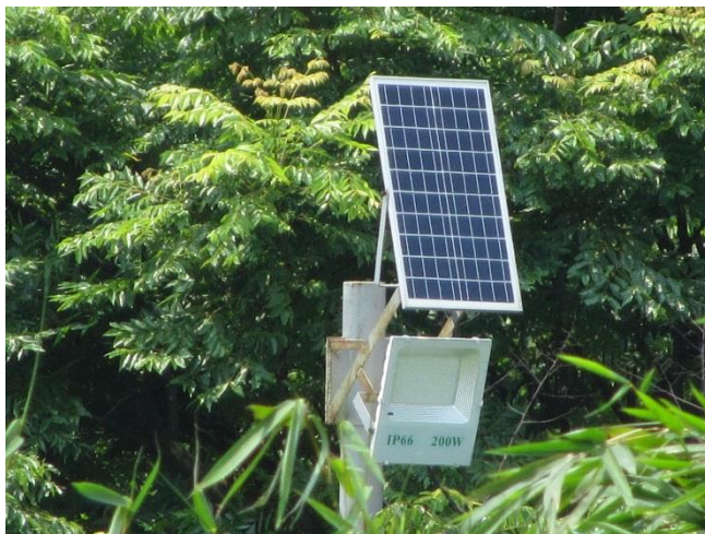
設置太陽光電照明設備系統
